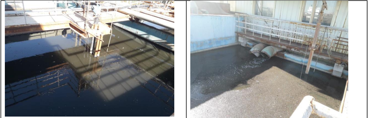
Рисунок 1-Текущее состояние сооружений
